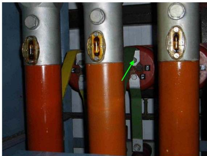
Slika 2. Izvadak iz termografskog izvješća za Rasklopište 10kV Nemetin (Nemetin), VP10kV BKTS Cesta
